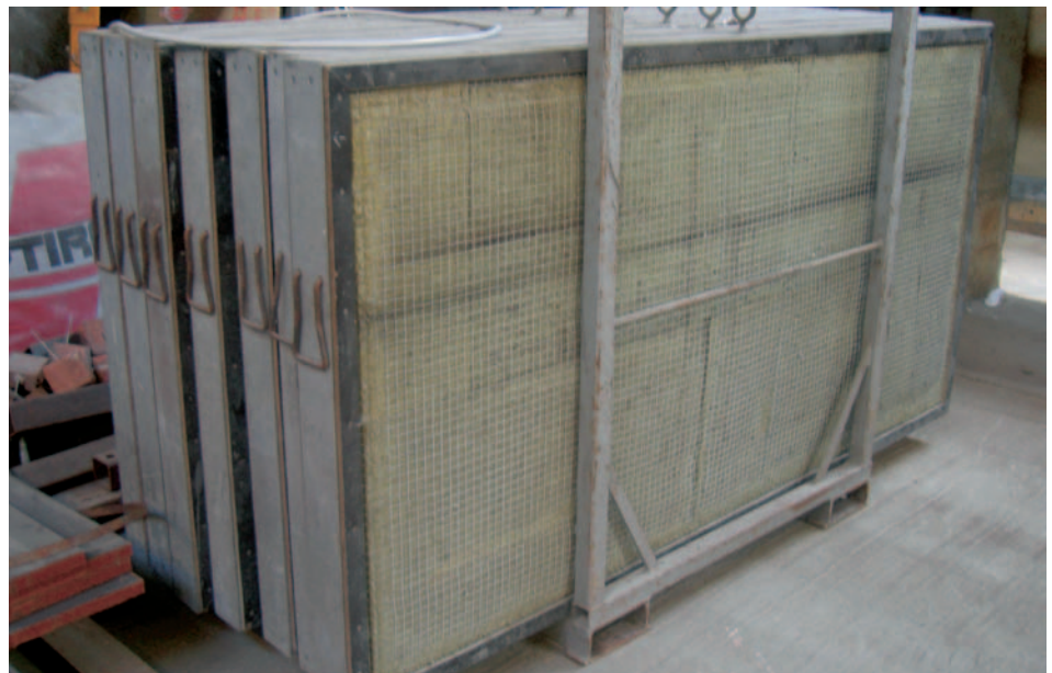
Støjskærme til at dæmpe ved slibning af forme
