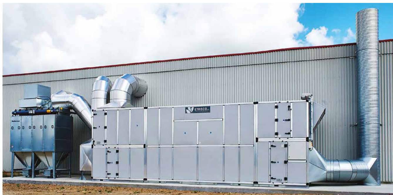
Eksempel på aggregat med varmegenvinding og filter
